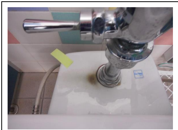
女子トイレ 給水管接続部周辺の水垢
