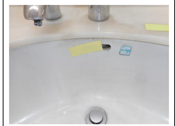
女子トイレ 洗面台周辺の水垢等による汚れ
