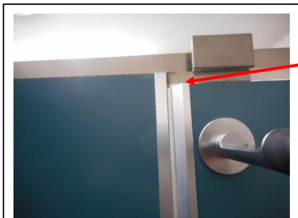
女子トイレ ドアがぶつかって閉まりにくい
