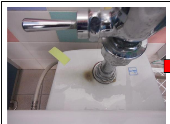
女子トイレ 大便器の水垢等による汚れ
