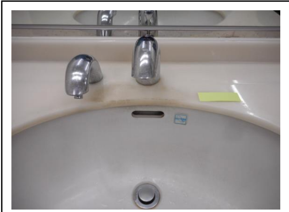
男子トイレ 洗面台周辺の水垢等による汚れ
