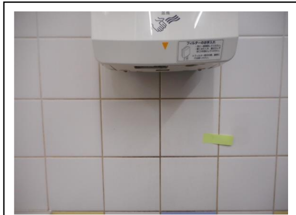
女子トイレ ハンドドライヤー周辺の壁の汚れ
