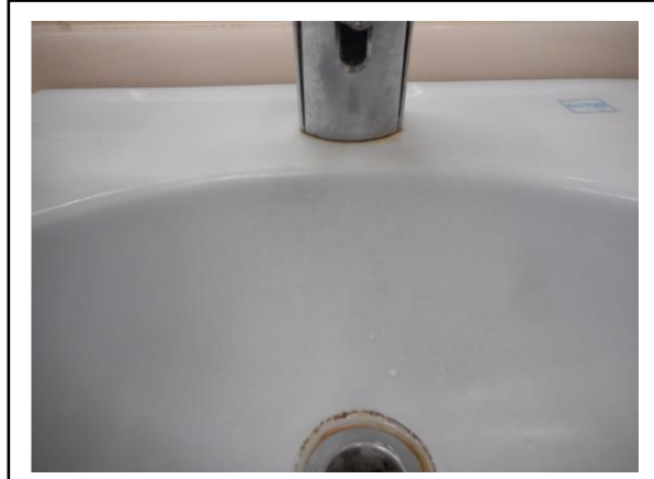
男子トイレ 子供用洗面台周辺の水垢等による汚れ
