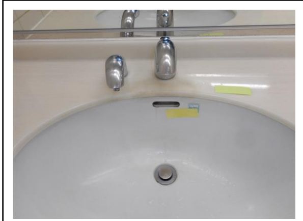
女子トイレ 洗面台周辺の水垢等による汚れ
